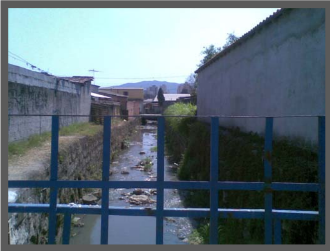
Foto 18 Ribeirão Negro – Canalizado e com lançamento de esgotos “in natura”.
