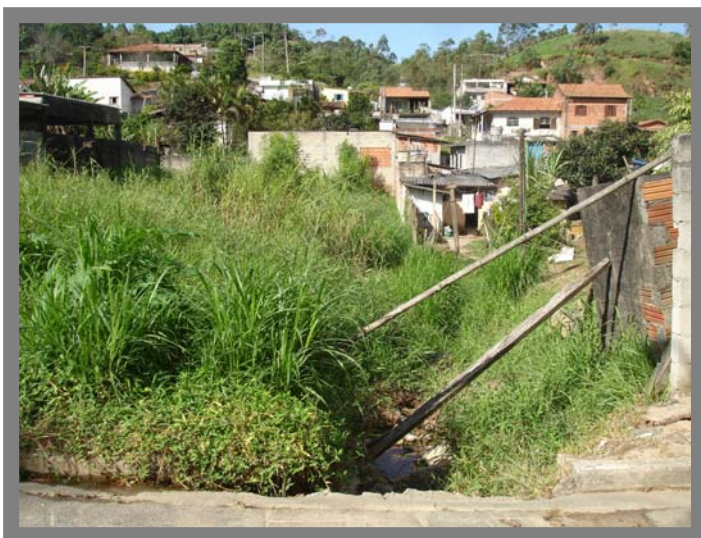
Foto 4 Rua Santa Cruz do André – vista de córrego com muro desabando em suas margens.
