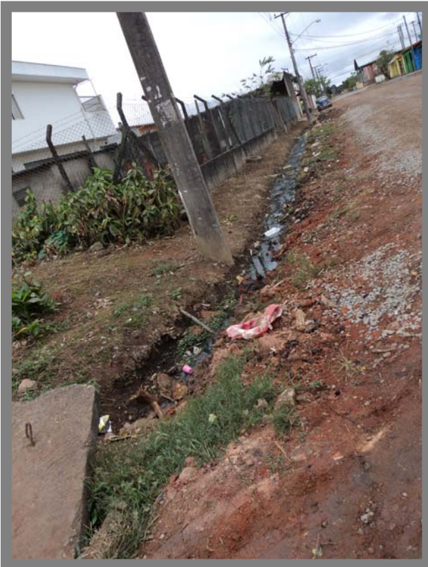
Foto 22 Jundiapéba – Esgoto a céu aberto - Rua sem rede de esgoto.
