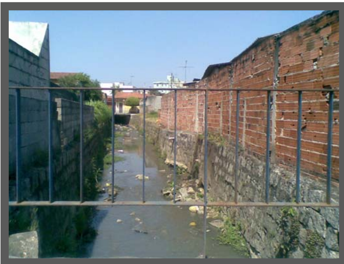
Foto 19 Ribeirão Negro – Canalizado e com lançamento de esgotos “in natura”.
