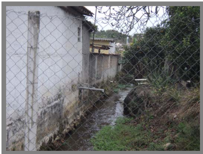
Foto 47 Córrego com lançamentos de esgoto “in natura” – Área se coleta de esgoto.
