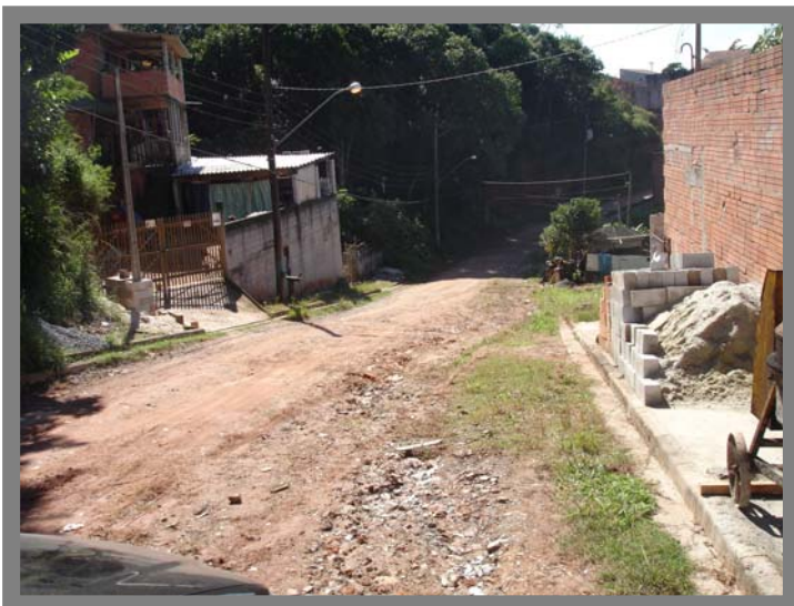
Foto 10 Rua Francisco Regis de Oliveira – Área sem rede de esgoto.
