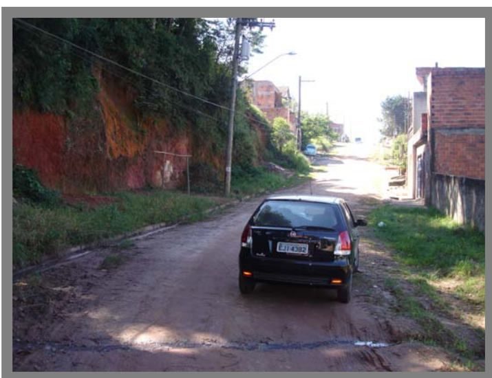
Foto 11 Rua Francisco Regis de Oliveira – esgoto a céu aberto.
