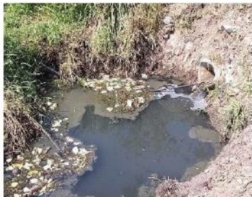
Esgoto a céu aberto
